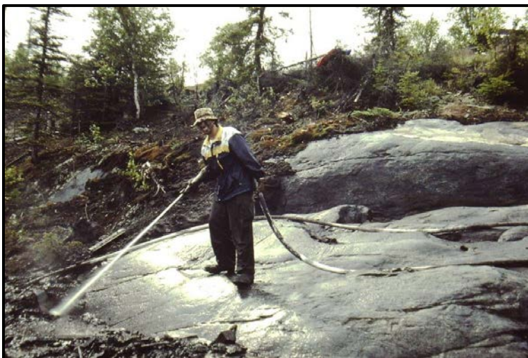
Photo 5 : Diverses techniques, dont le nettoyage à jet puissant, servent au décapage et au nettoyage des morts-terrains.
